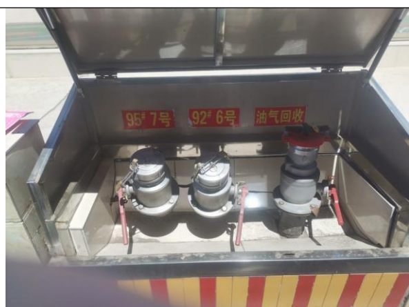
卸油油气回收
