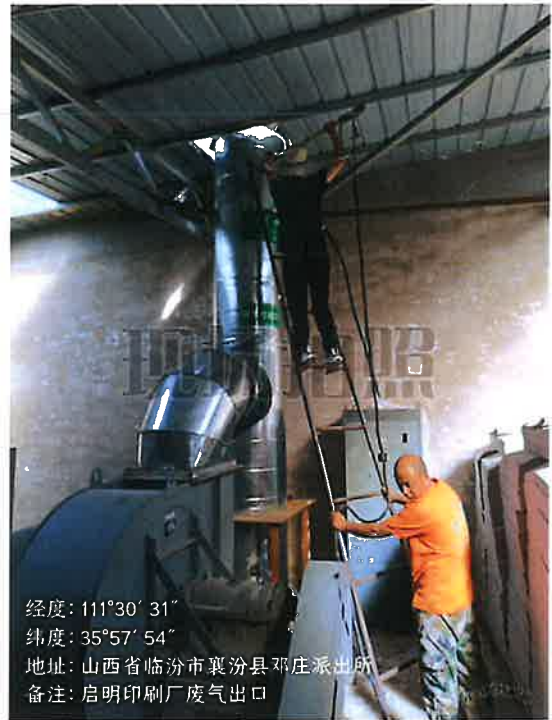
有机废气处理设施出口
