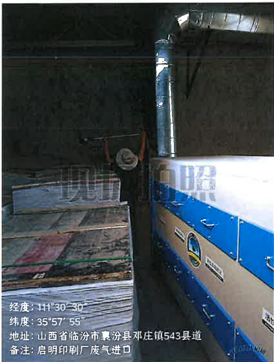
有机废气处理设施进口
